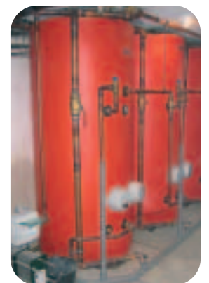
Ballons de stockage de l'eau chaude sanitaire et échangeur de chaleur
