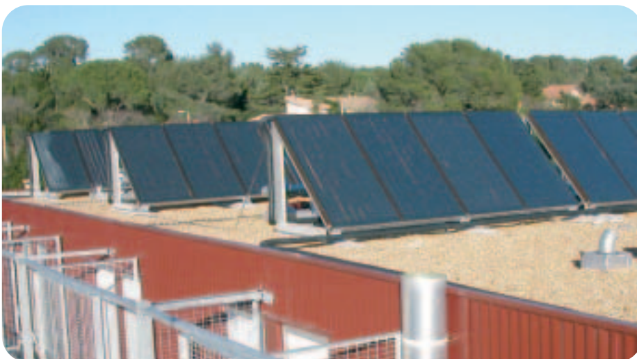
Capteurs solaires pour l'eau chaude sanitaire
